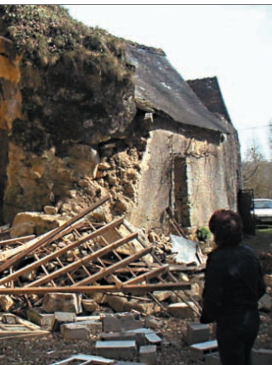
Conséquences d'un effondrement de coteau
